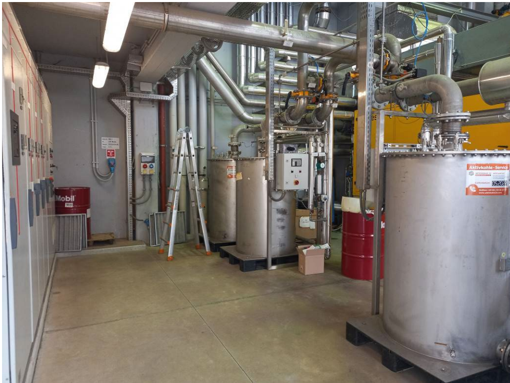
Foto 14: Quadri elettrici e trattamento silossani
