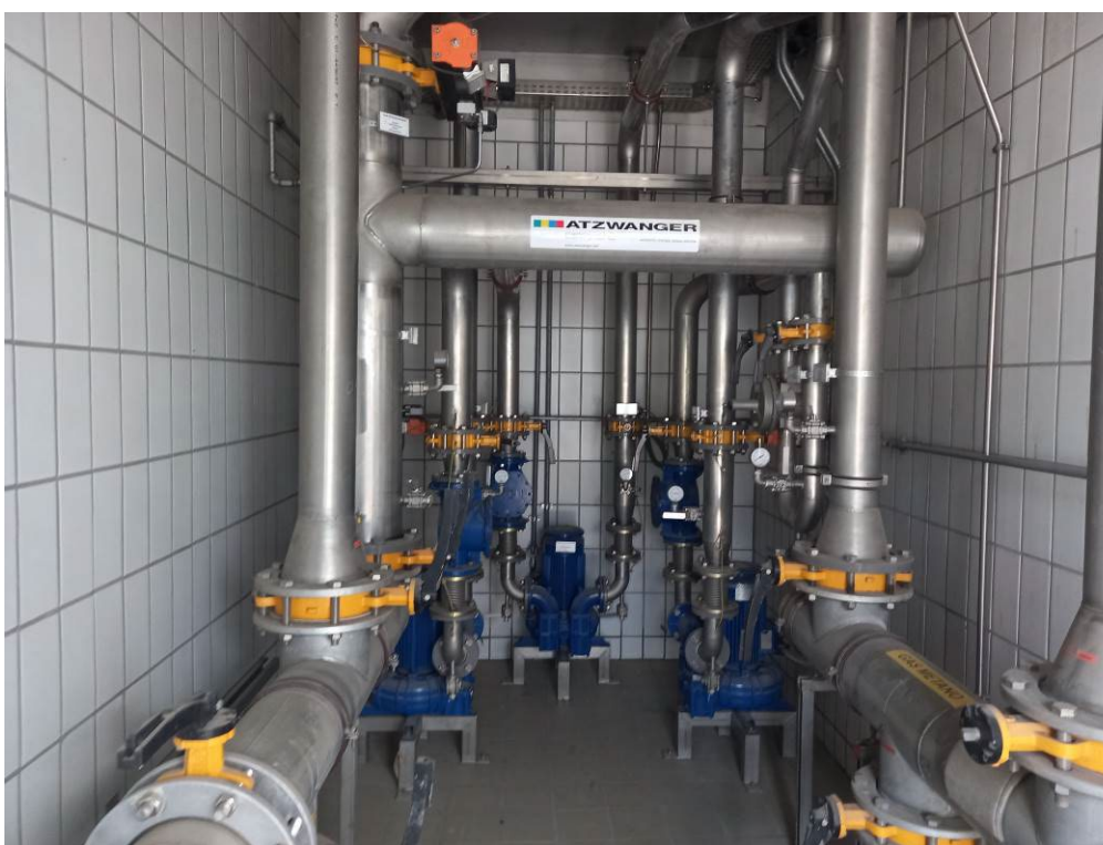
Foto 16: Locale distribuzione biogas con soffianti biogas
