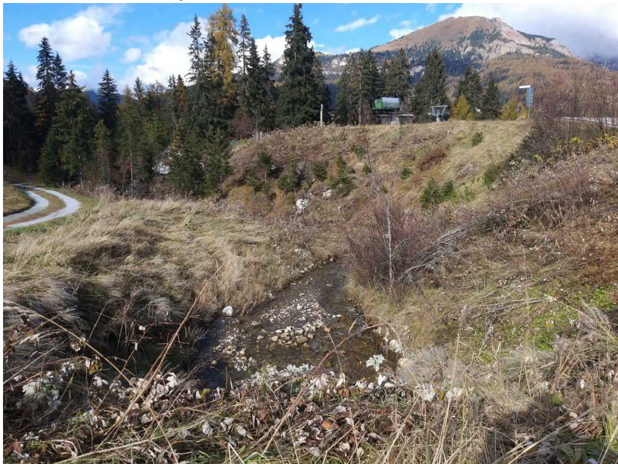
Foto 12 : Bereich Stütze Nr. S8
